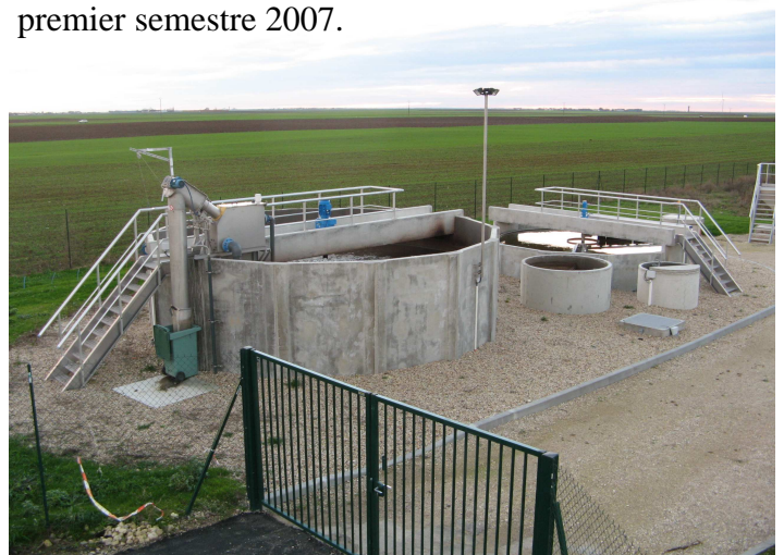
Les bassins de la nouvelle station d'épuration
